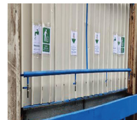
各区域新增设大量洗手池
