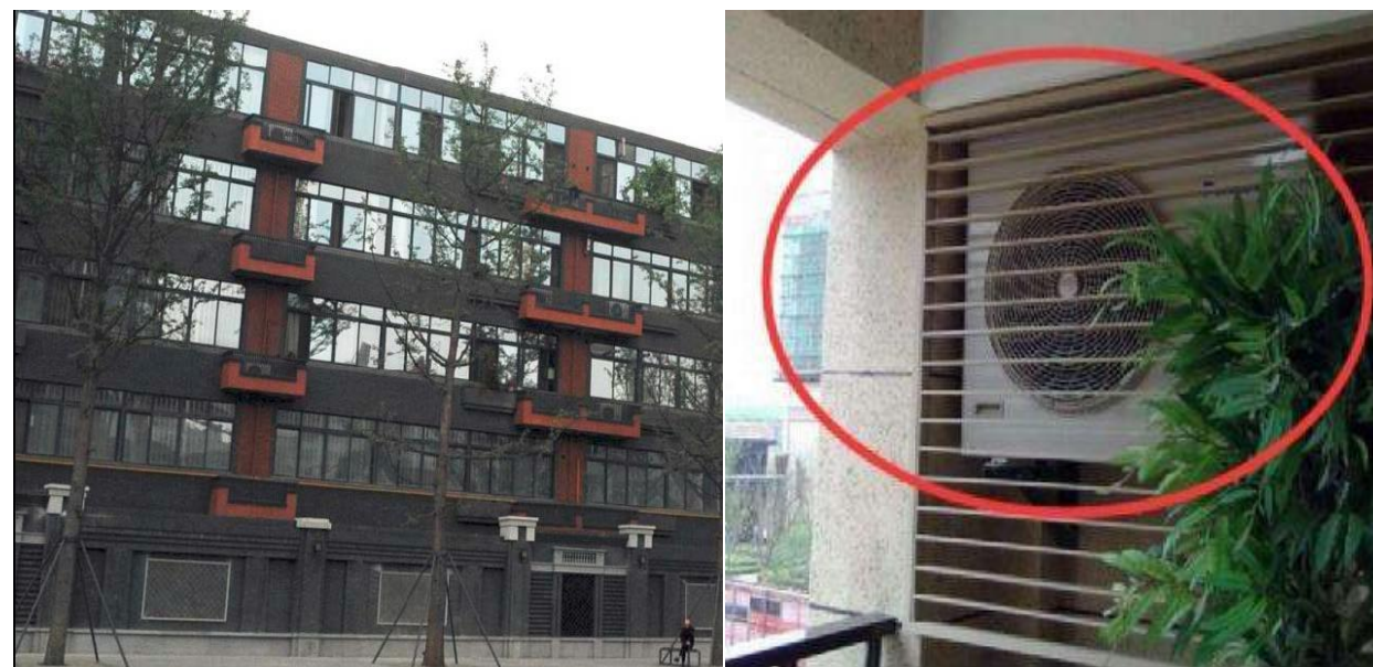
图6-1-12 空调外机遮挡示例
